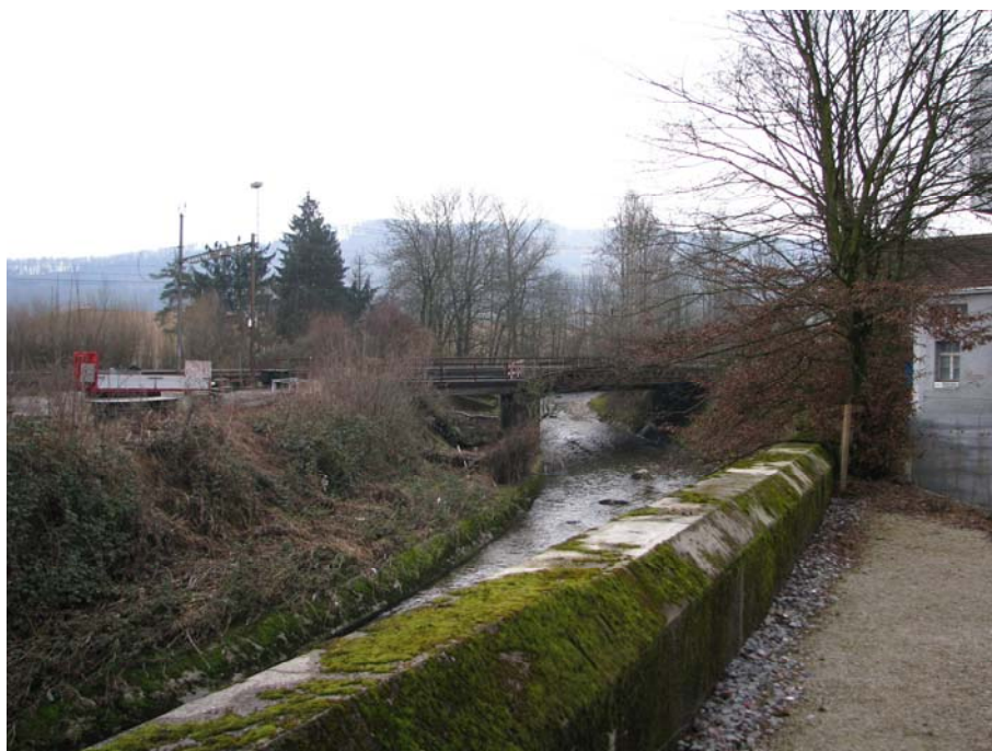
Abb. 21: SBB-Brücke in Olten (Foto 2008) mit Blick gegen die Fließrichtung. Der Brückenpfeiler und die Verkräutungen beeinträchtigen den Abflussquerschnitt.
