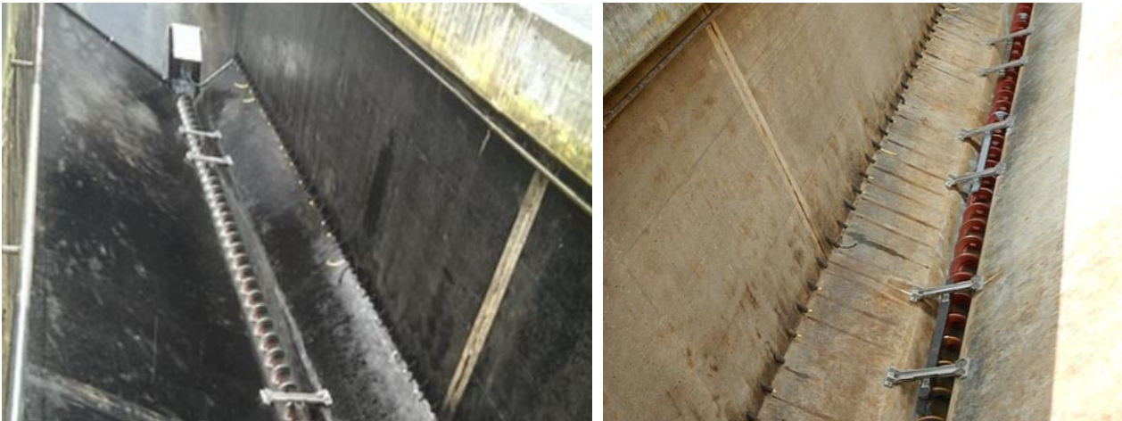
Abbildung 99: Beispiel einer Förderschnecke im Sandfang der ARA Sensetal (Bilder: www.sensetal.ch ). Durch die Rotation der Förderschnecke werden Feststoffe aus dem Sandfang transportiert. Wenn die Förderschnecke in einem geschlossenen Rohr verläuft, können Feststoffe auch aufwärts transportiert werden.
