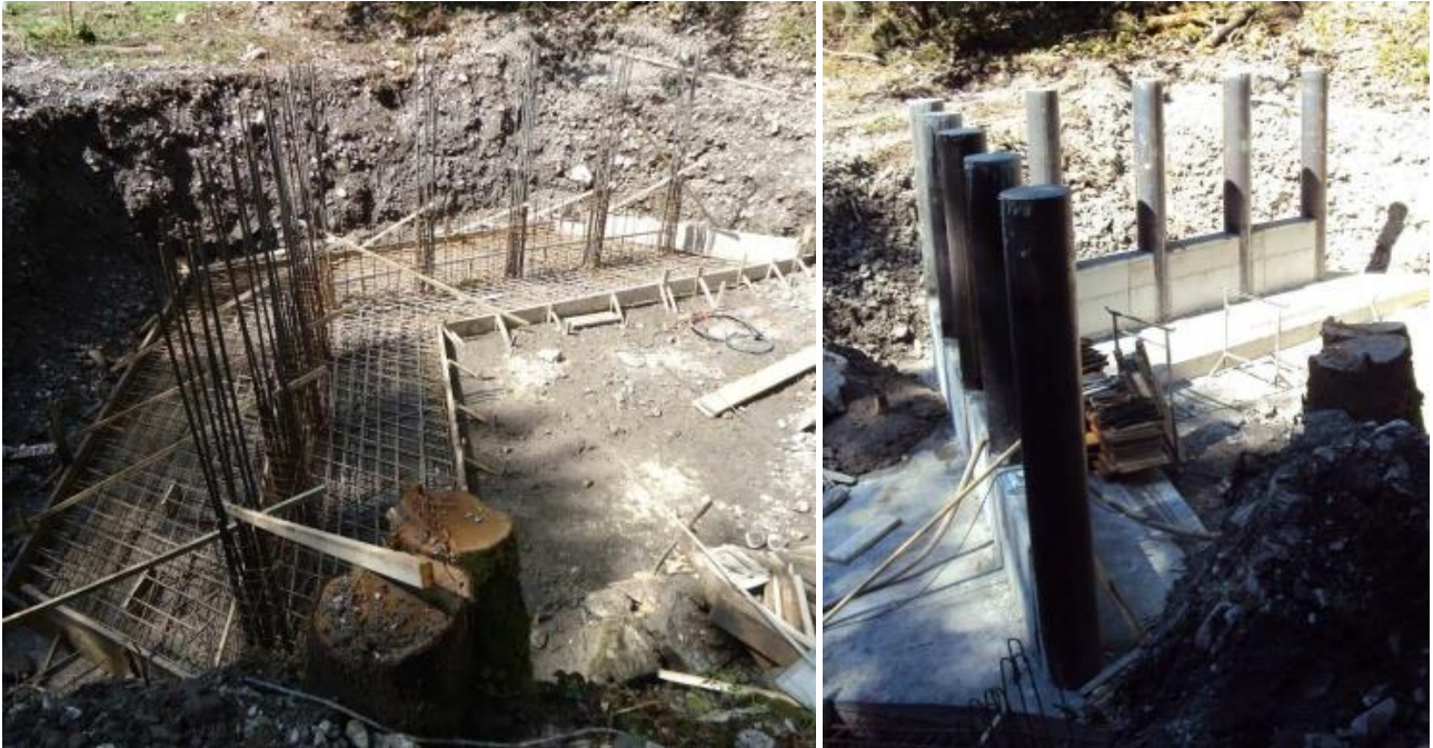
Abbildung 53: Beispiel für den Bau eines V-förmigen Schwemmholzrechens am Reidenbach in Boltigen (Emch+Berger AG Bern).
