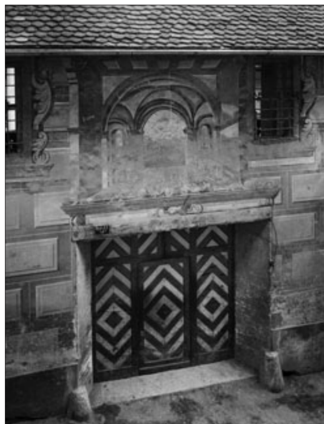
Abb. 1 Solothurn, St. Urbangasse 40, Fassadenmalerei, Zustand um 1925.
