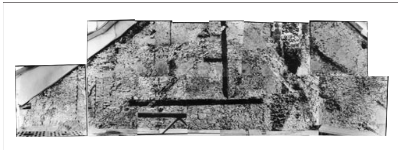
Abb. 20 Teilansicht der westlichen Brandmauer. Fotomontage aus 14 Einzelaufnahmen, Zustand nach dem Entfernen der versengten Verputzsichten. Befundanalyse vgl. Abb. 18.
