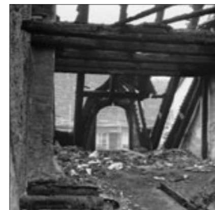
Abb. 5 Blick in den Estrich nach dem Brand vom 5. November 1988.
