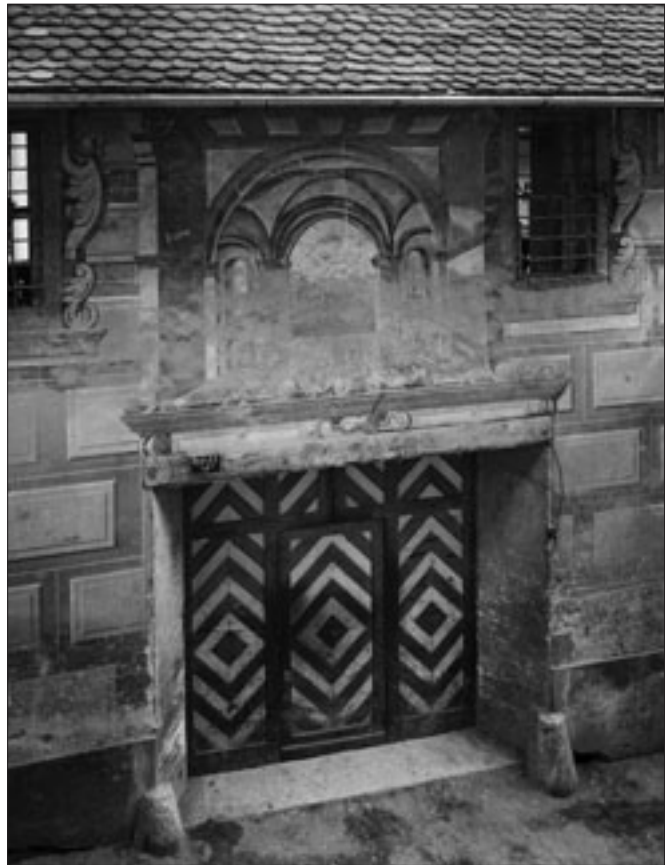
Abb. 1 Solothurn, St. Urbangasse 40, Fassadenmalerei, Zustand um 1925.
