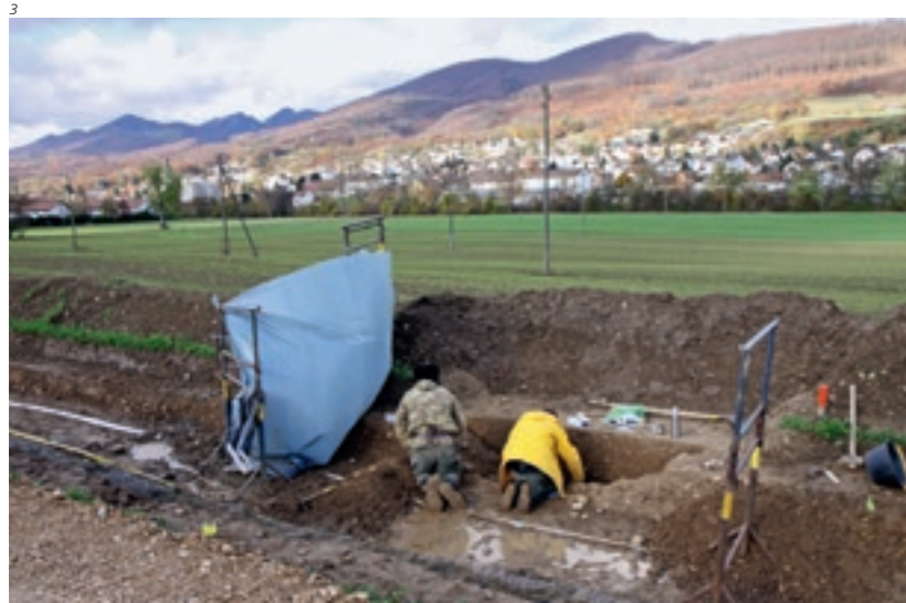
Abb. 2 Der Bagger hebt den Werkleitungsgraben aus. Im linken Teil des Profils dunkel verfärbte Schichten einer modernen Schuttdeponie. Blick Richtung Wangen bei Olten.
