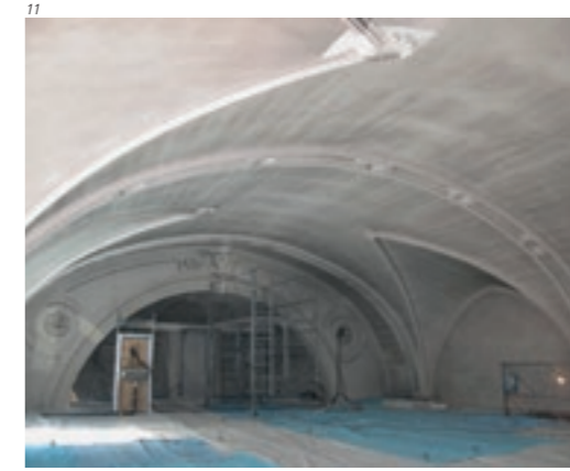
Abb. 11 Blick in das stark verschmutzte Gewölbe. Foto während der Restaurierung 2014.
