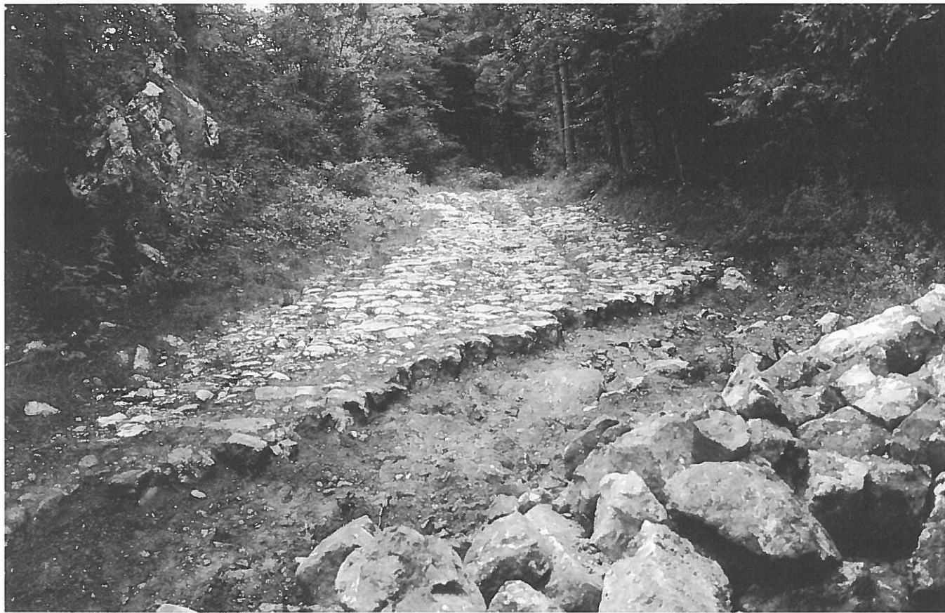
Abb. 1: Balsthal/ am Stalden. Die zerstörte Strassenpflasterung.
