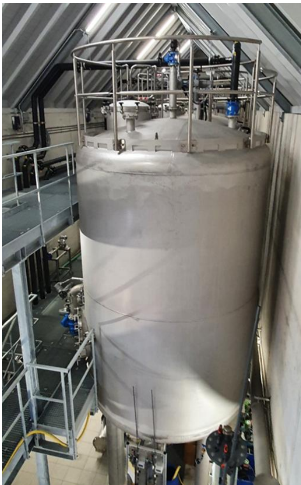
Abbildung 8: Beispiel eines Filterbehälters aus Edelstahl (Aktivkohlefiltration des Wasserwerks Rauental in Rastatt D)
