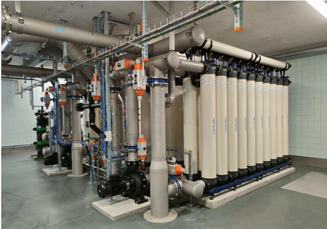
Abbildung 11: Ultrafiltration der SPAK-UF-Anlage der Seeländischen Wasserversorgung in Worben (Quelle Membratec)
