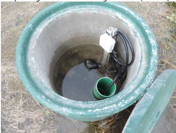
Schacht mit Niveau-Schwimmerschalter (18.5.2017).
