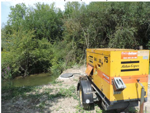
Provisorische Notspeisung mit Dieselpumpe (7.8.2018).
