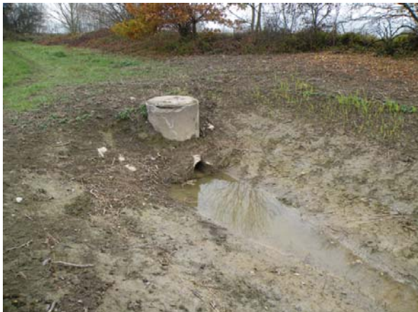
Schacht mit Standrohr zur Regulierung des Wasserstands.
