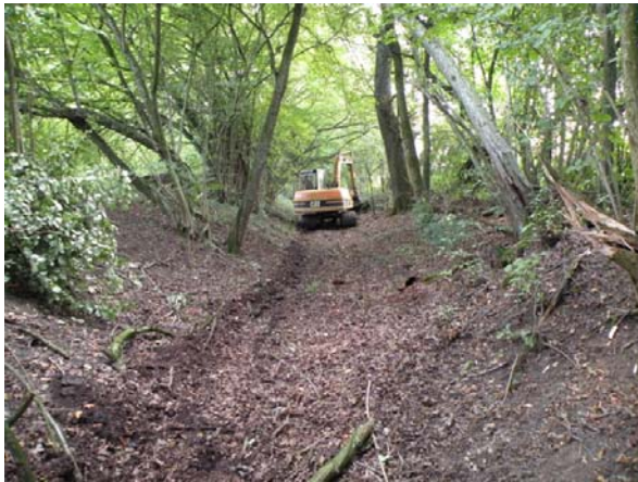
Trockenes Gerinne vor Instandstellung.
