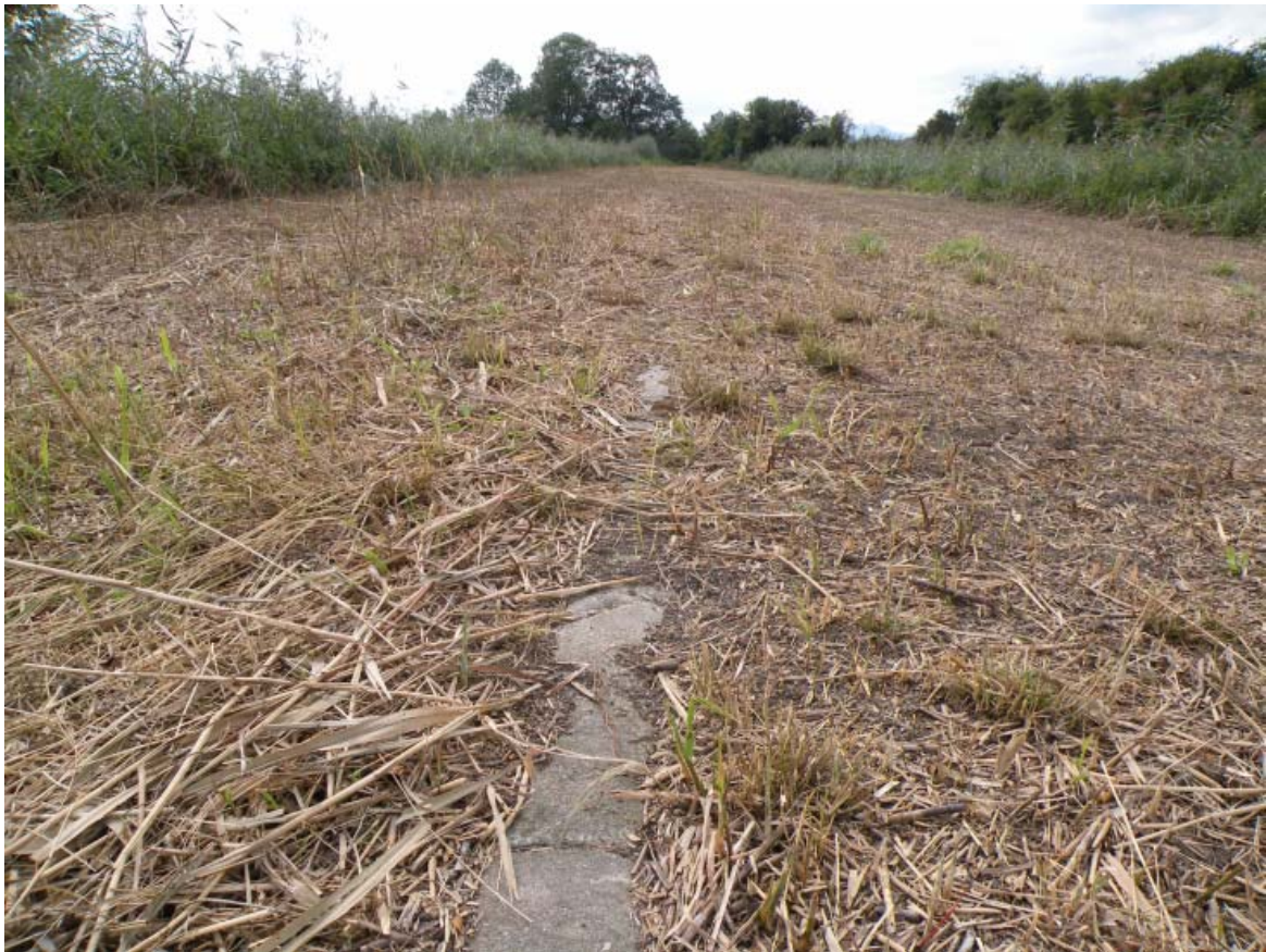
Betonrohr, unerwünschte Drainage in die Leugene.
