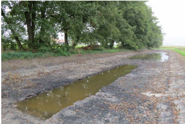
Wasser dringt ein (4.10.2013).
