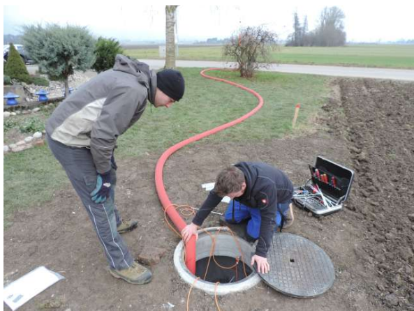
Die Pumpe ist montiert; Testlauf mit Wasser ab Hydrant (20.12.2016).
