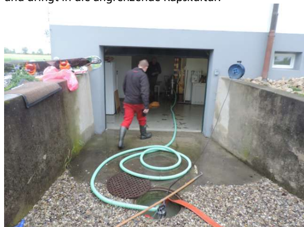
Aus Schacht G in der Kellereinfahrt des Hofes Galmen läuft Wasser in den Keller und das dortige Büro. Der Schaden ist beträchtlich.
