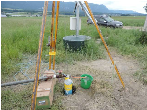
Brunnenrohr mit angeschlossener Leitung (1.6.2016).
