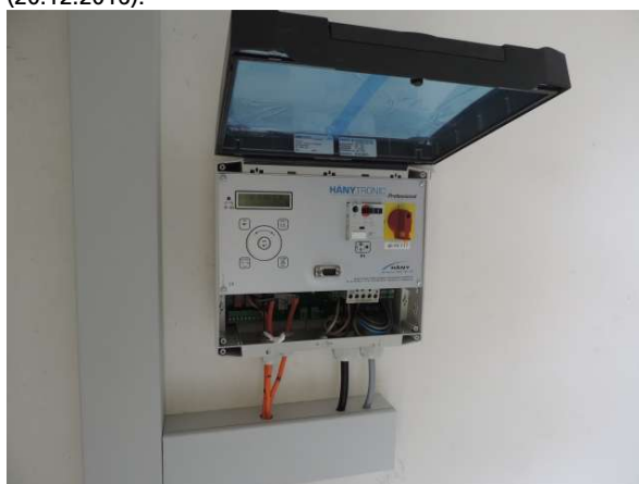
Steuerungskasten im Keller. Bei Fehlfunktion ertönt ein Alarm (20.12.2016).
