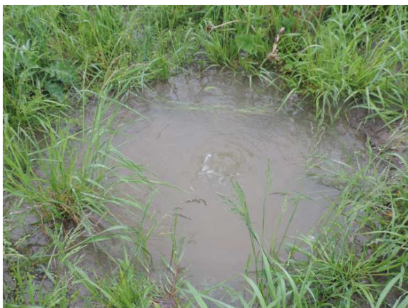
Die Drainage ist im Rückstau, das Wasser sprudelt aus Schacht D1 im Egelsee Nord.
