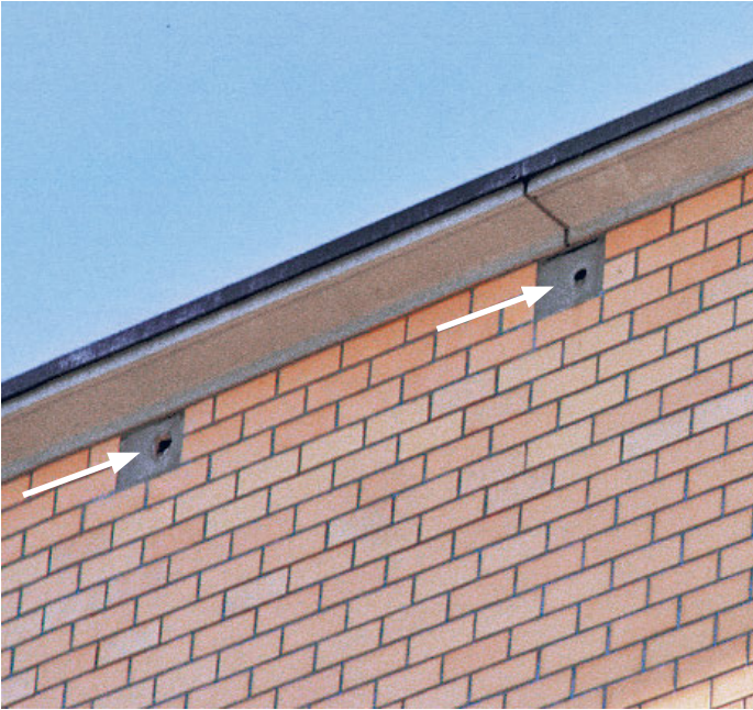
In die Fassade eingelassene Niststeine.
