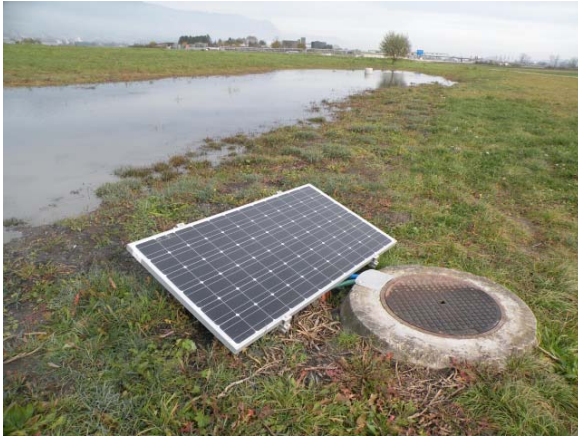
Speisung Tümpel Ostportal A5 mit Solarpumpe aus Drainagehauptleitung.
