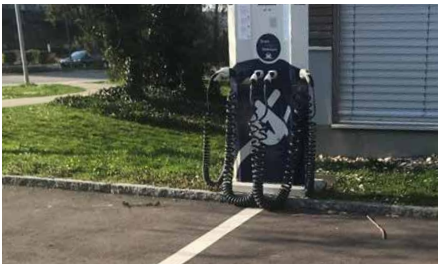
E-Tankstelle der Gemeinde Kaiseraugst
