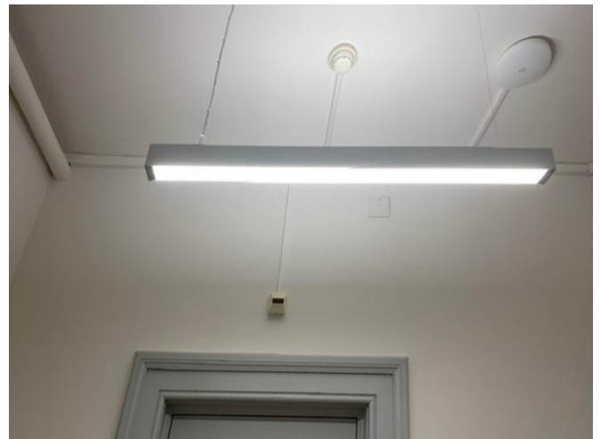
Korridorbeleuchtung 1. OG Bild Hochbauamt
