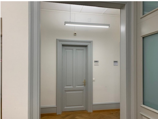
Korridorbeleuchtung 1. OG Bild Hochbauamt
