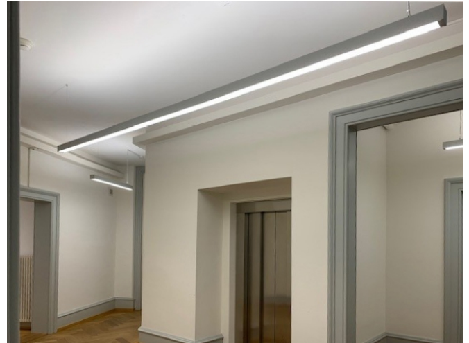
Korridorbeleuchtung 1. OG Bild Hochbauamt
