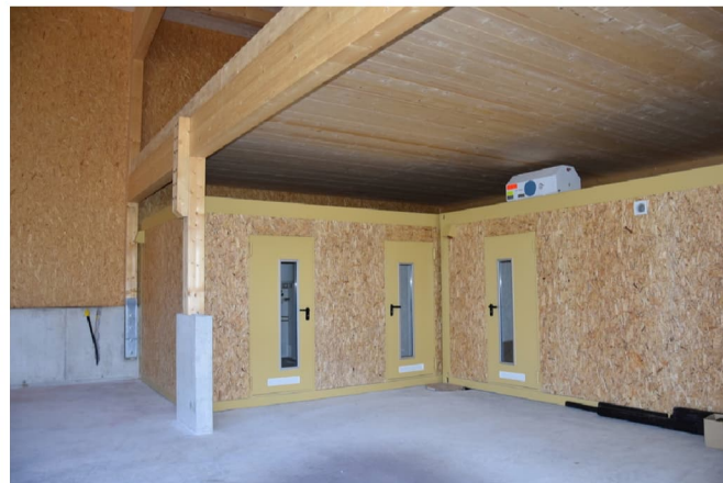
Module Warmräume Bild HBA
