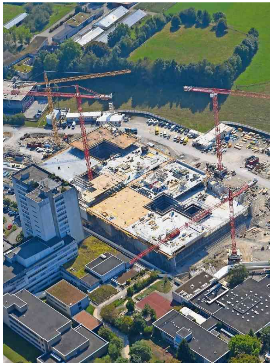
Der Flachbau (gegen Westen) wird Anfang Oktober im Rohbau fertig sein. PETER BROTSCHI
