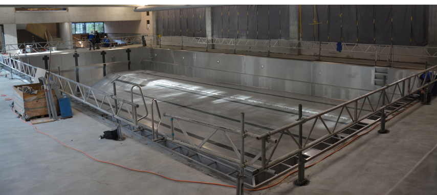
Das Hallenbad besitzt neu ein Chromstahlbecken. (Bild: vwe)
