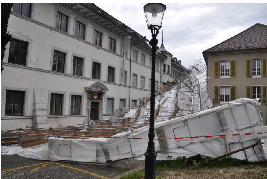
Solothurn: umgestürztes Baugerüst
