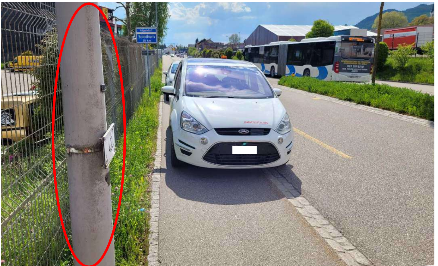
Ri Olten, Kandelaber A46, Nachtstrom, Bigbox; Kabel kurz
