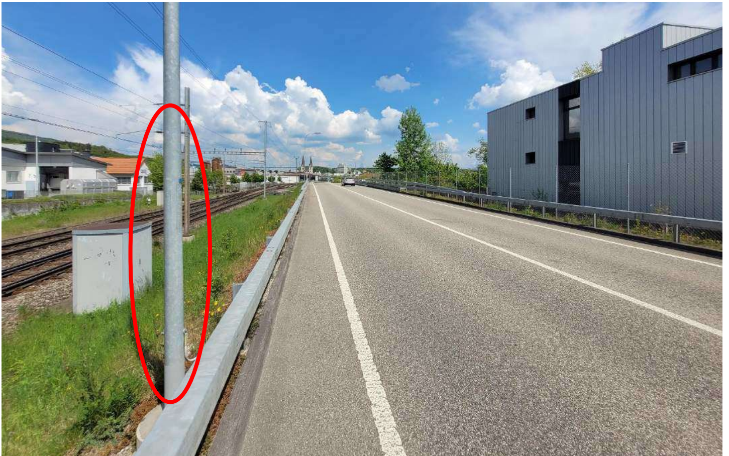
47.3479931, 7.8908012; Ri Egerkingen, Kandelaber 16, Nachtstrom; Bigbox, Kabel kurz
