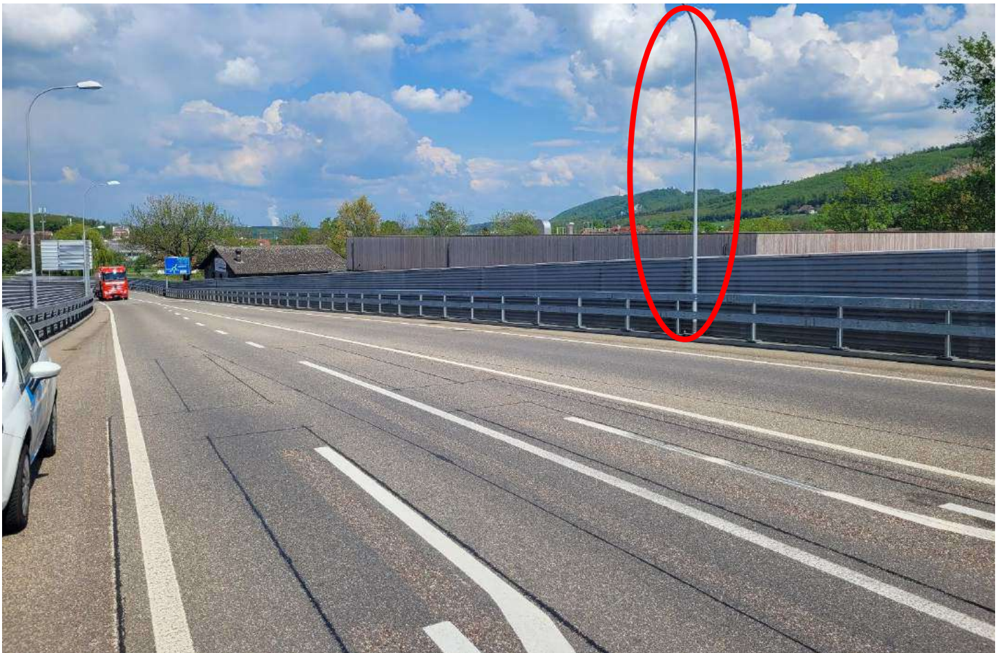
47.3404414, 7.8679308; Ri Entlastungsstrasse, Kandelaber, Nachtstrom, Bigbox; Kabel kurz
