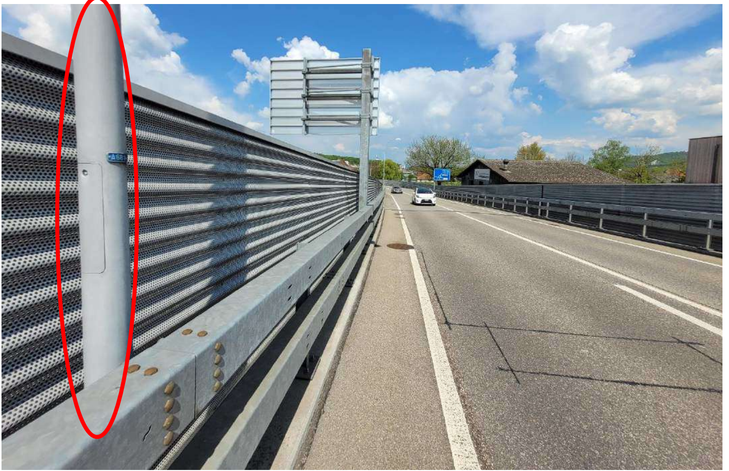
Standort 4 | 47.3404671, 7.8681459; Ri Viadukt, Kandelaber, Nachtstrom, Bigbox; Kabel kurz
